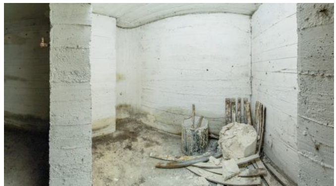
Abb. 134: Panoramablick in den Beobachterraum. In der linken Ecke die Rundung für die Kleinstglocke. Sowjetische Behälter mit eingetrockneter Schlämmeerde.
