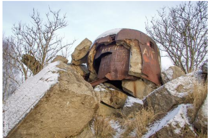
Abb. 2: Reste der Attrappe eines Dreischartenturmes am gesprengten Übungs-Infanteriewerk. Der umgebende Beton weist keine „ernsthafte“ Stahlbewehrung auf. Döberitz, 2002.
