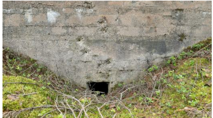
Abb. 89: Die Scharte ist fast vollständig verschüttet.
