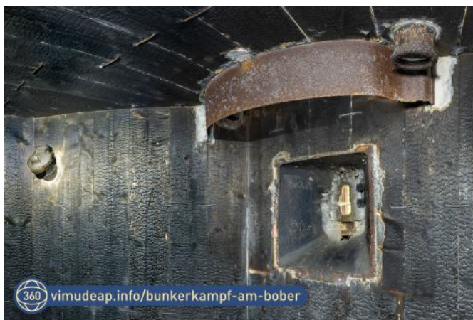
Abb. 45: Durch Brand beschädigte Holzverkleidung in einem vz. 37 A-140 bei Heřmanice. Über dem Stahleinsatz der Mauerscharte das Leitblech für Pulvergase und der Stützen für das Periskop. Links ein Handgranatenauswurf.
