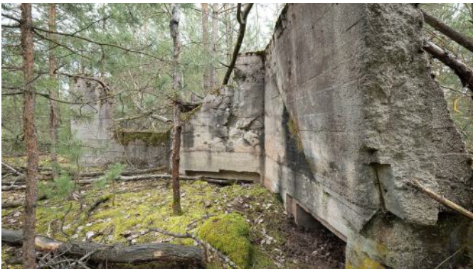
Abb. 102: Hofseite mit verschütteter Flankierungsscharte und verschüttetem Eingang rechts im Vordergrund.
