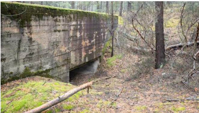
Abb. 123: Der Zugang zum Pak-Unterstellraum im Bauwerk 16 ist stark verschüttet.
