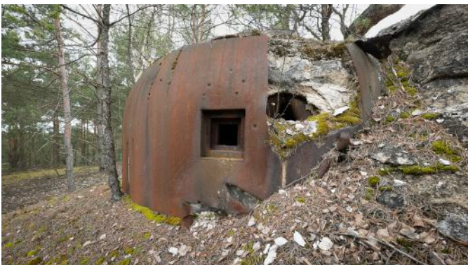
Abb. 32: Beschädigter Dreischartenturm am Werk I. Zwischen der inneren und äußeren Blechverkleidung ist die Betonfüllung gut zu erkennen.
