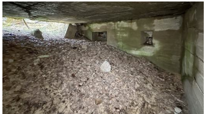
Abb. 105: Verschütteter Bereitschaftsraum. Links die zerstörte Decke des Zugangs zu den Kampfräumen. Rechts die Flankierungsscharte von innen.
