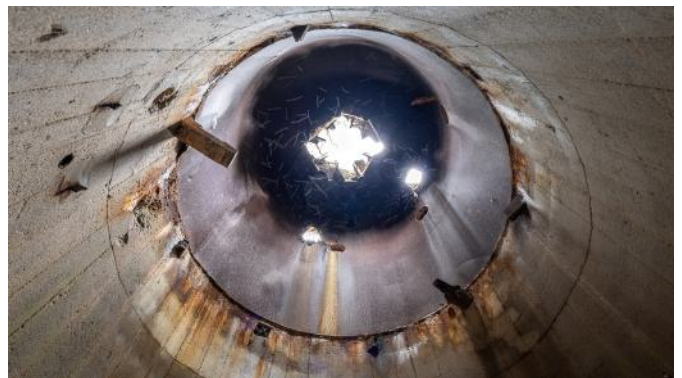
Abb. 33: Lichteinfall im beschädigten Dreischartenturm am Werk I. Zu erkennen sind die einstigen Positionen der Plattform und der Leiter, sowie die Auflage des Turmes.
