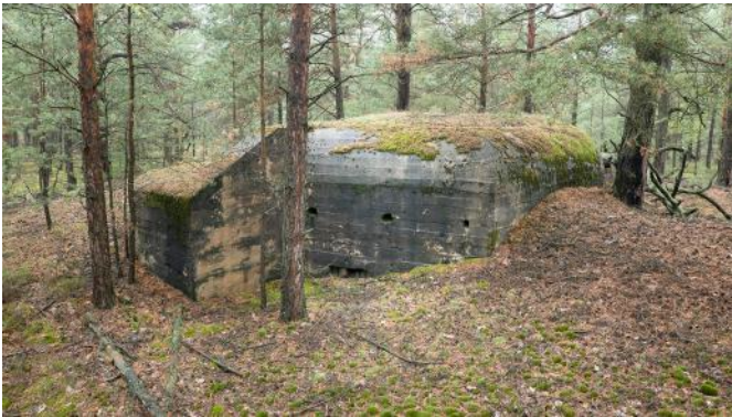
Abb. 61: Die flankierende Scharte von Stand 3 ist fast verschüttet. Die Flügelmauer ist bei diesen Modellen deutlich kürzer als bei den Modellen mit zwei flankierenden Scharten.
