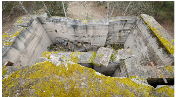
Abb. 37: Durch das Fehlen der Stahlträger ist die fast nicht bewehrte Decke von Werk I eingestürzt. Blick Richtung Eingang und in die Kampfräume hinter den Mauerscharten.
