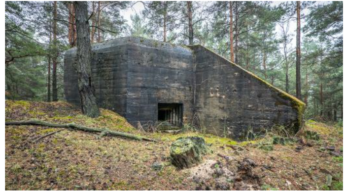
Abb. 47: Westliche Scharte mit Flügelmauer des Schartenstandes 4. Der Trennungsgraben davor ist verschüttet. Der größte Teil der frontseitigen Anschüttung ist erodiert.
