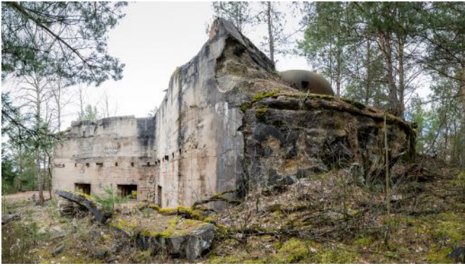
Abb. 34: Dreischartenturm und Mauerscharten am Werk I. Teile der herabgestürzten Decke überdecken den Trennungsgraben.
