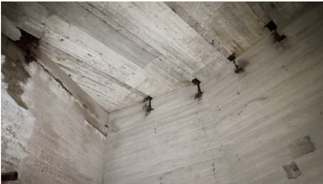
Abb. 36: Decke im Werk III. Die Stahlträger wurden entfernt. Nur im Werk II sind sie in Stahlbeton ausgeführt. Noch hält die 20 cm starke Decke, die im Werk I bereits eingestürzt ist.
