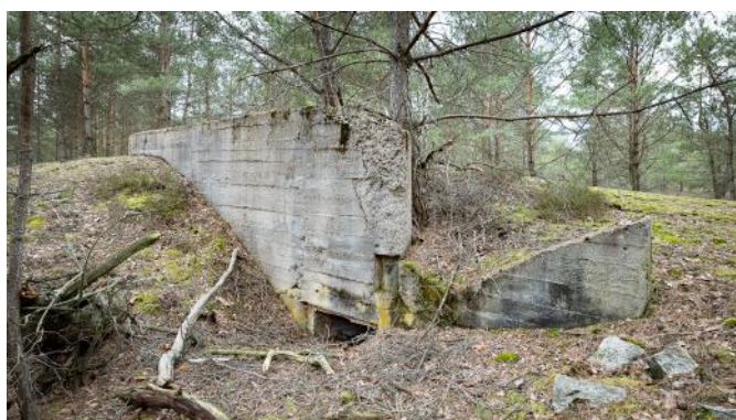
Abb. 139: Obwohl Bauwerk 15 außen stark beschädigt ist, ist das Innere noch gut erhalten, vgl. Abb 140.
