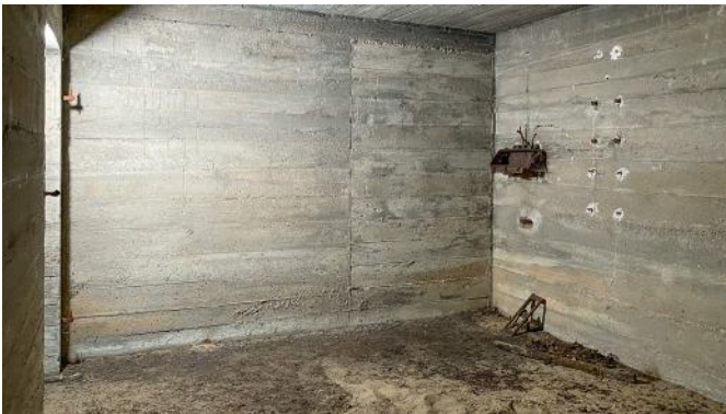
Abb. 125: Im linken Bereitschaftsraum von Bauwerk 16 sind noch die Reste eines Kabelendverschlusses zu finden.
