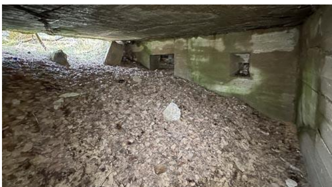
Rys. 105: Zasypane pomieszczenie pogotowia. Po lewej zniszczony strop dojścia do pomieszczeń bojowych. Po prawej strzelnica flankująca od wewnątrz.
