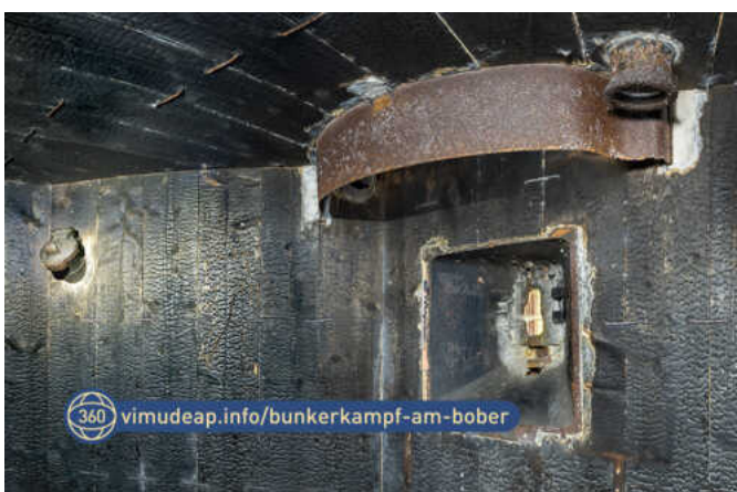
Rys. 45: Drewniana boazeria uszkodzona przez pożar w schronie wz. 37 podtyp A-140 w pobliżu Heřmanic. Nad stalową wkładką wnęki czerpnia na gazy prochowe i rura dla peryskopu. Po lewej zrzutnia granatów ręcznych.
