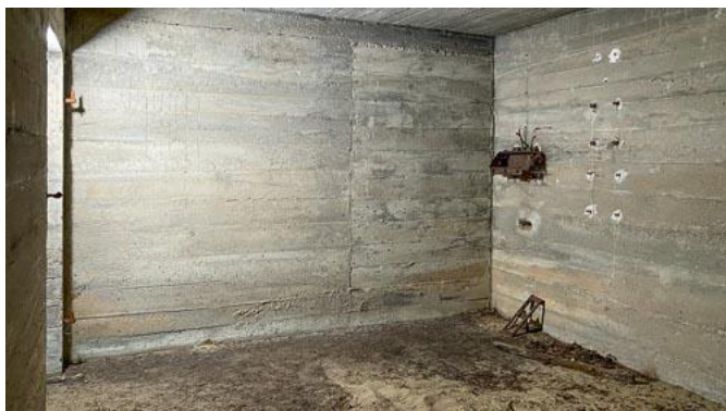
Rys. 125: Pozostałości zakończenia kabla nadal można znaleźć w lewym pomieszczeniu gotowości w Schronie nr 16.
