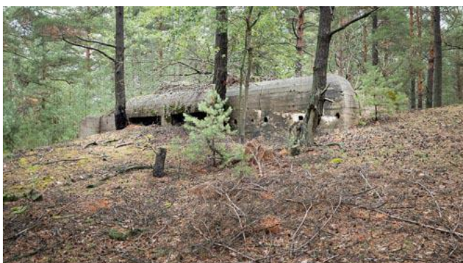
Rys. 59: W miarę erozji zasypu po prawej stronie ukrywa się strzelnica czołowa Schronu nr 5. Podobieństwa z schronem wz. 37 podtypu B1-90.
