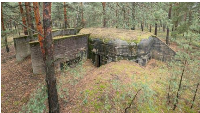
Rys. 78: Widok odpowiadający Rys. 76 od strony północnej. Po prawej stronie częściowo zasypany otwór strzelniczy ze ścianą skrzydłową.
