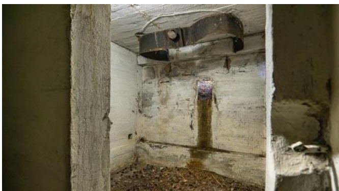
Rys. 91: Izba bojowa z prawie całkowicie zasypanym otworem strzelniczym. Nad nim czechosłowacka czerpnia gazów prochowych, por. Rys. 111f.
