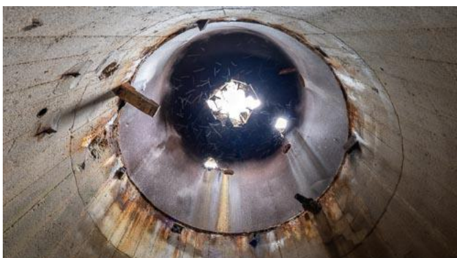
Rys. 33: Światło prześwitujące w uszkodzonej trójstrzelnicowej kopule w Werku I. Można rozpoznać położenie platformy i drabiny, a także podpory kopuły.
