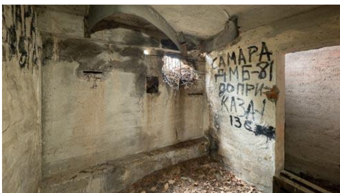
Rys. 98: Dziura po pocisku obok strzelnicy w przedziale bojowym. Zniszczona czechosłowacka czerpnia gazowa, por. rys. 111f.
