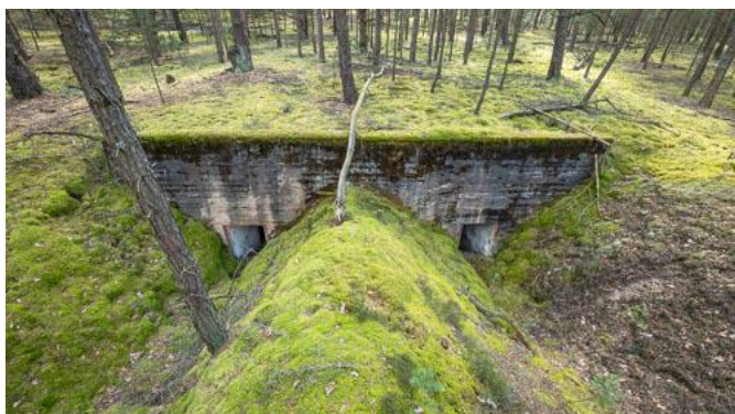
Rys. 132: Widok od strony zapola z dwoma prawie wysadzonymi wejściami do schronu.
