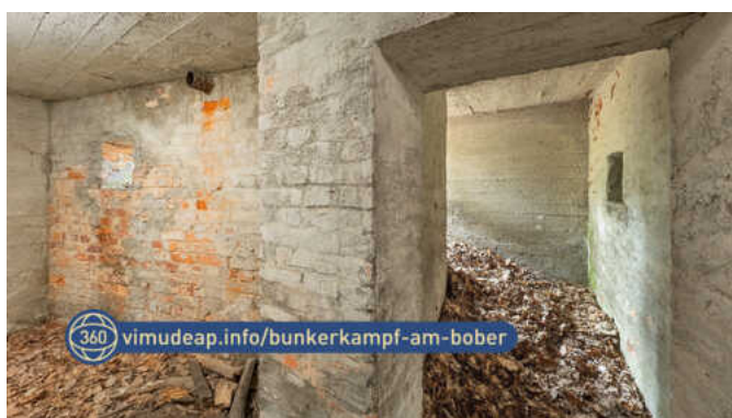
Rys. 109: Widok na wartownię po lewej stronie i na śluzę gazową ze strzelnicą obrony wejścia.
