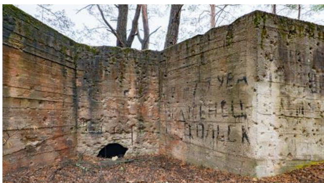
Rys. 130: Ściana frontowa z cyrylicą i zniszczonym otworem strzelniczym. Ślady po kulach pochodzą prawdopodobnie od wojsk radzieckich.
