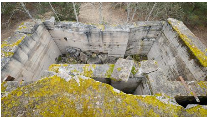
Rys. 37: Z powodu braku stalowych dźwigarów zawalił się prawie niewzmocniony strop Werku I. Widok w kierunku wejścia i do pomieszczeń bojowych za strzelnicami.
