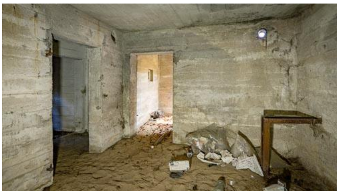
Rys. 90: Izba pogotowia z widokiem w kierunku obrony wejścia. Wentylator systemu wentylacji był zainstalowany na cokole po prawej stronie.
