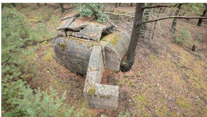
Rys. 62: Widok na częściowo zasypaną strzelnicę i ścianę skrzydłową Schronu nr 5. Wysadzenie od wewnątrz spowodowało podniesienie i rozbicie stropu w tym obszarze.
