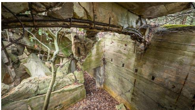
Rys. 65: Widok ogólny wnętrza Schronu nr 5 przez podniesiony sufit z żelbetowymi belkami. W centrum zdjęcia ściana działowa pomiędzy dwoma izbami bojowymi.
