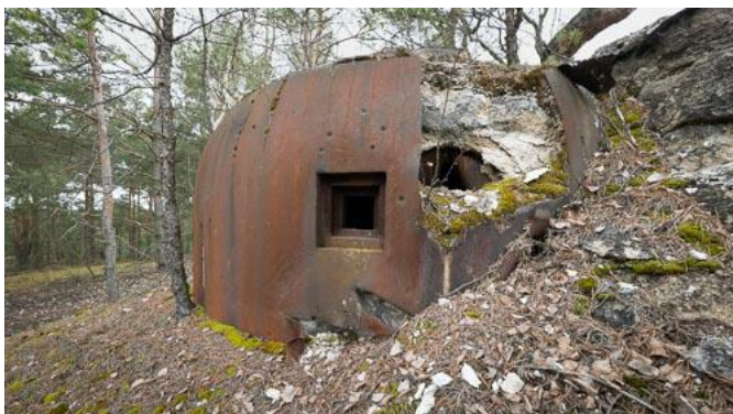
Rys. 32: Uszkodzona trójstrzelnicowa kopuła w Werku I. Wypełnienie betonowe pomiędzy wewnętrzną i zewnętrzną blachą jest wyraźnie widoczne.
