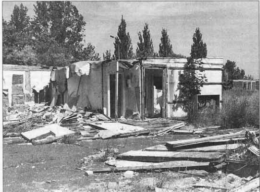
Eingerissen und liegen gelassen, so zeigt sich der einstige Motelkomplex.
